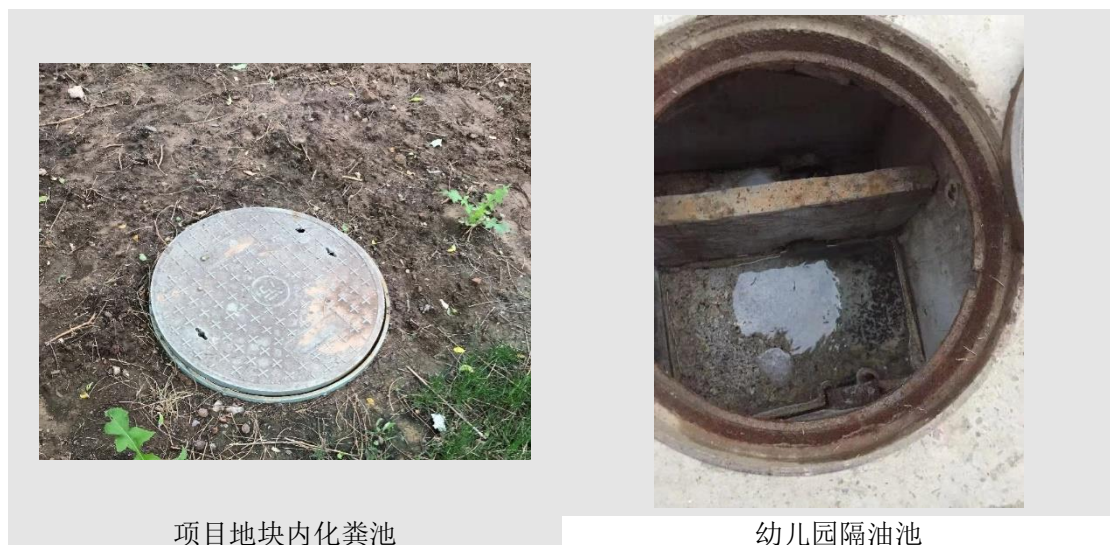
图 4.1-1 本项目废水处理设施照片
