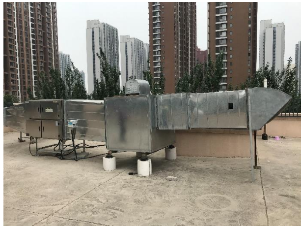
幼儿园食堂油烟废气排放口
