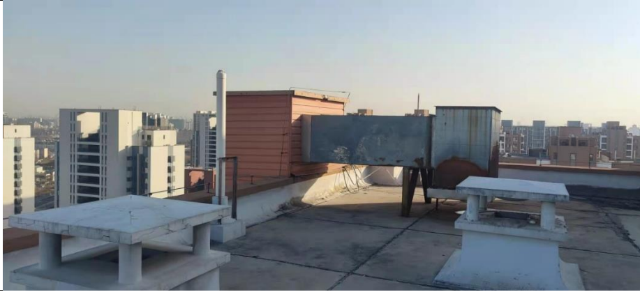
锅炉废气排气筒
