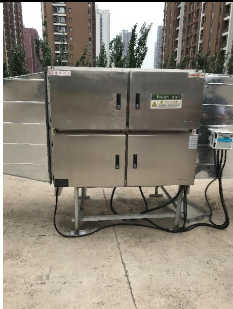
幼儿园食堂油烟废气净化设施
