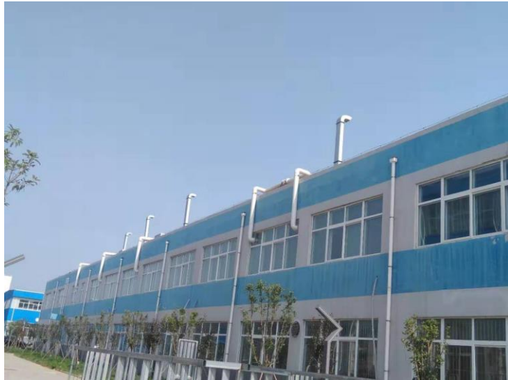
图4-5 1209车间锡焊排气筒
